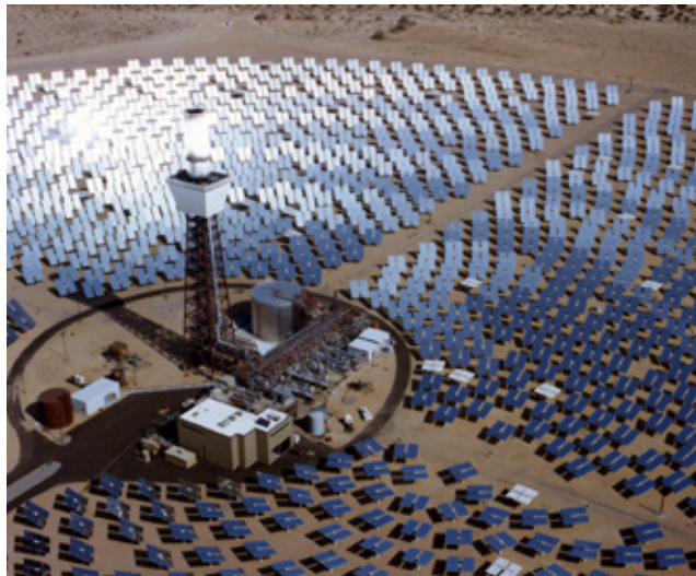
CCSP de torre de concentración.
